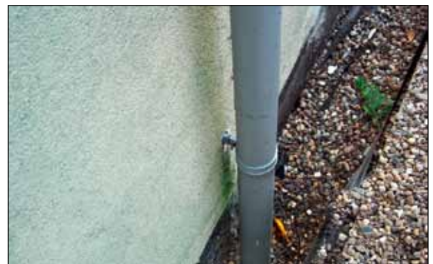
DETAIL 1: Beschadiging en vervuiling gevelstucwerk door onjuiste bevestiging van h.w.a..
