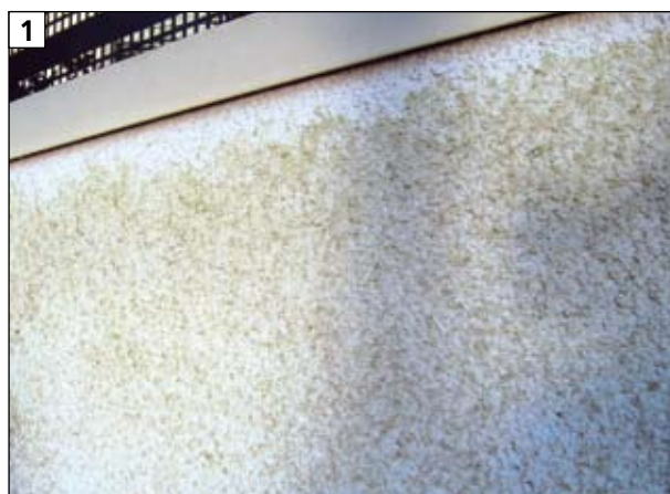
DETAIL 1: Vervuiling door onvoldoende overstek.
