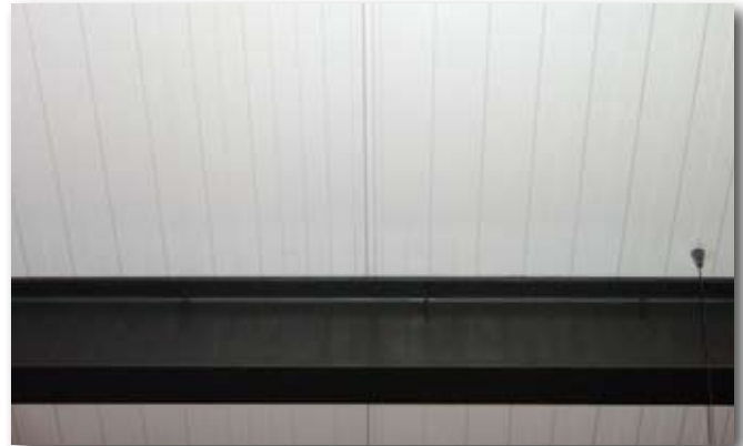
Zich breed aftekenende langsvoegen kunnen duiden op een onvoldoende dichting ter plaatse.
