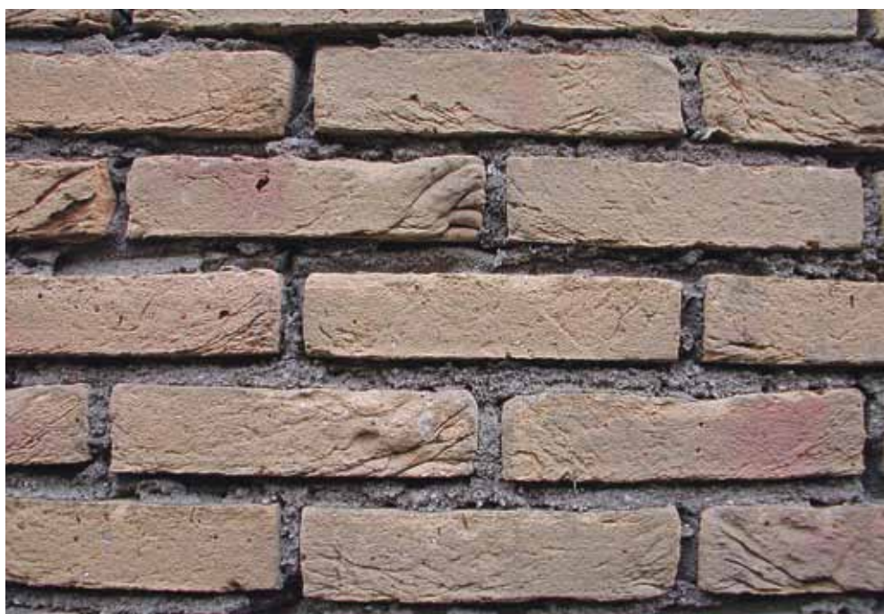
Schade aan stenen en voegwerk door onoordeelkundig reinigen.
