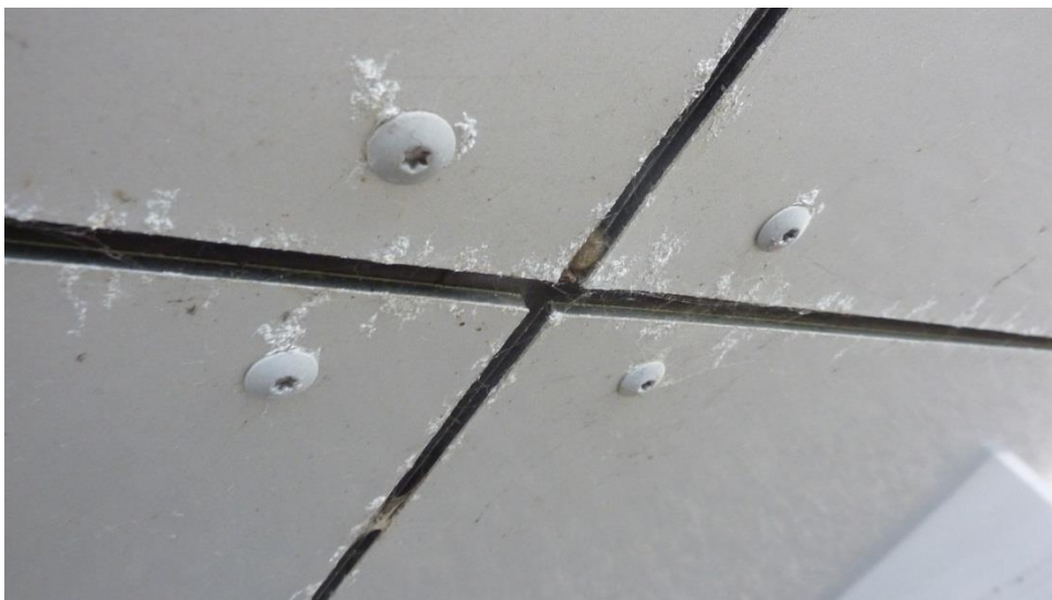
Foto 2: Ernstige filiforme corrosie vanuit randen en boorgaten bij aluminium plafondplaten.
