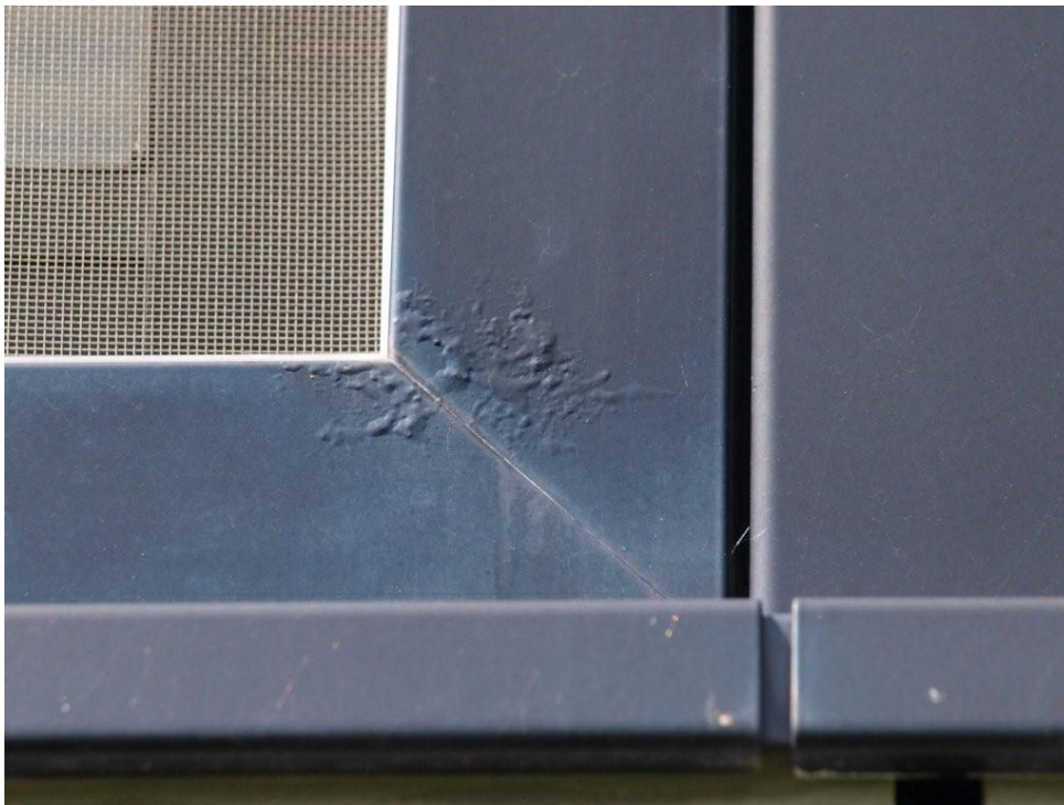
Foto 1: Filiforme corrosie vanuit de zaagkanten van aluminium kozijnprofielen.
