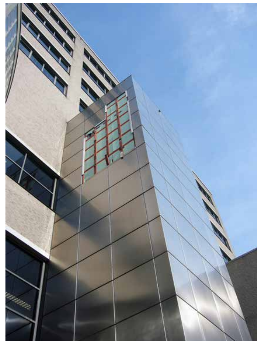
Een houten achterstructuur is niet geschikt voor een facadegevel.
