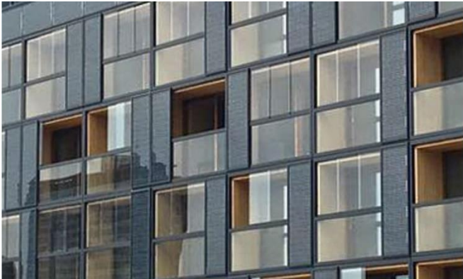
Gevel met PV-panelen
